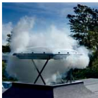
Sistema de evacuación de Humos y Carlor, CSP Pág. 10
